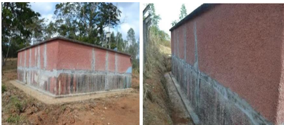
Figura 2.8 Reservatório fissurado do município de Viçosa, Minas Gerais, Brasil (SAAE, 2019).
